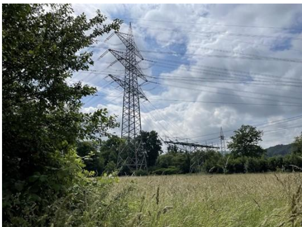
Freileitungen mit Metallgittermast im südlichen Teilbereich
