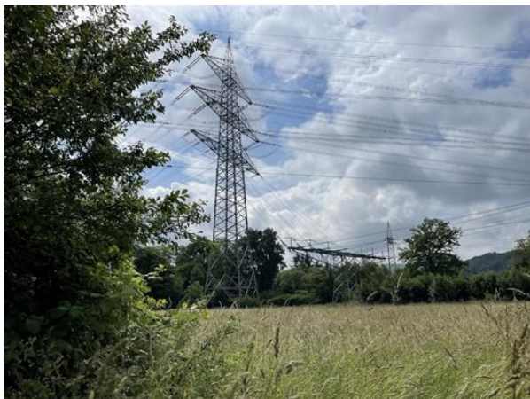
Freileitungen mit Metallgittermast im südlichen Teilbereich
